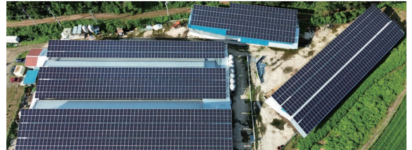
韓国屋上プロジェクト 設置時期: 2024
